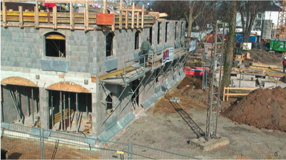
Abb. 93: Blick auf die Baustelle Bauernhof. View on the construction site of the farm.
