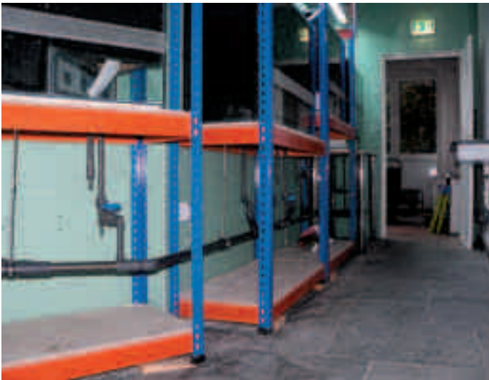
Abb. 14: Die Verrohrung der einzelnen Behälter. Piping of the single enclosures.
