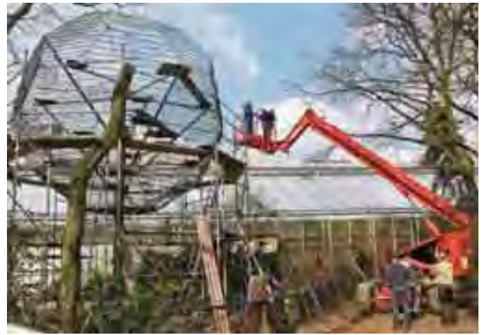
Abb. 46: Umsetzung einer Außenanlage für Affen am Urwaldhaus. Installing of a new outdoor enclosure for primates at the big ape house.
